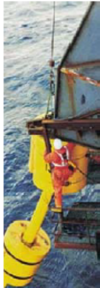
Junta flexível conectando o primeiro SCR (steel catenary riser) projetado e instalado no Brasil à plataforma semi-submersível Petrobras18.
