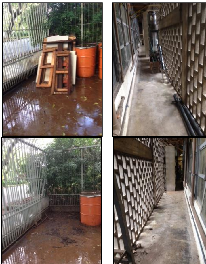
Figuras 32 . Resíduos inservíveis retirados no prédio do Minas.
