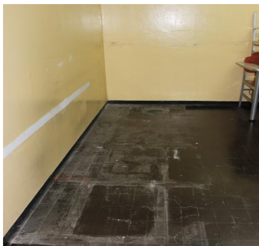
Figura 10. Sala após os móveis serem retirados.
